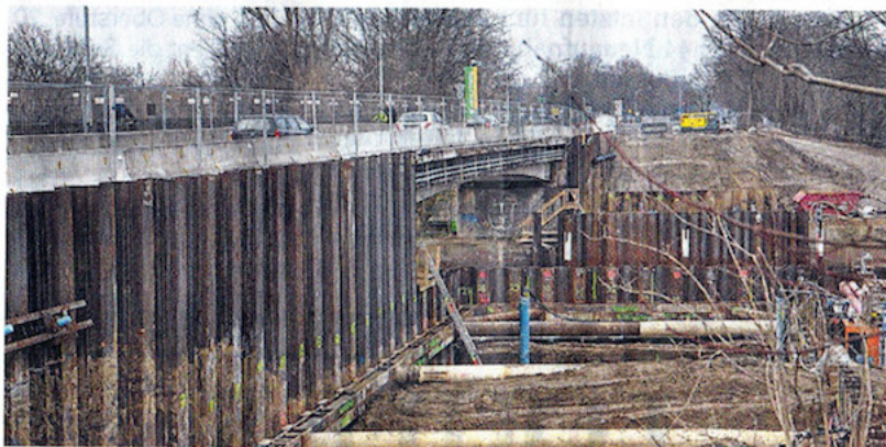
Komplexe Baustelle: Für die neue Brücke werden 76 riesige Pfähle ins Erdreich unter dem Kanal gebohrt, damit die Querung sicher steht. FOTO: KRÖGER
